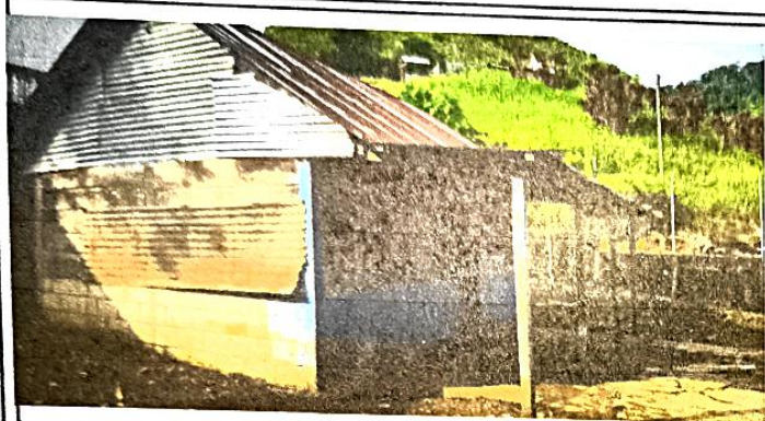
SE NECESITA CAMBIAR EL TECHO DE LA COCINA
