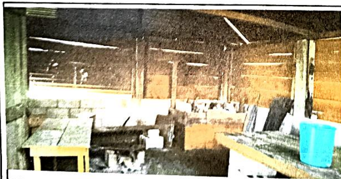
SE NECESITA COLOCAR PISO DE CEMENTO EL LA COCINA
