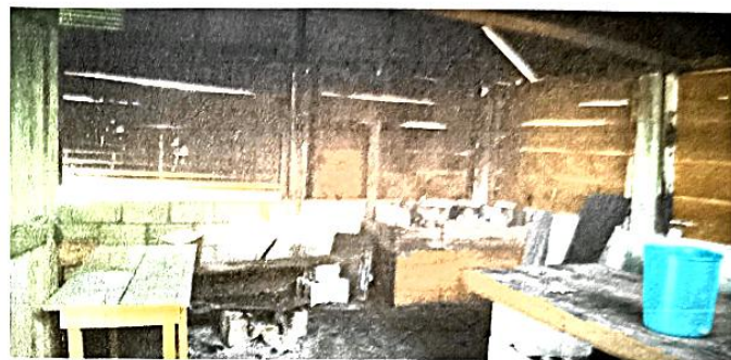
SE NECESITA CAMBIAR LA PARED DE LA COCINA
