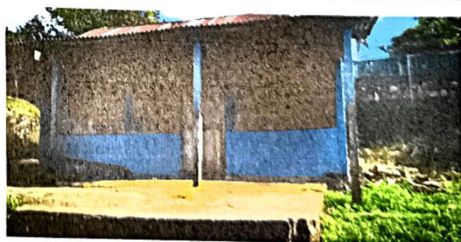
SE NECESITA CABIAR LA PUERTA DE LA COCINA
